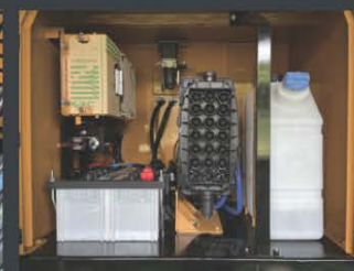
Équipement auxiliaire centralisé
